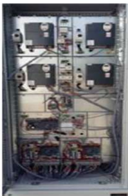
Convertidores de frecuencia de variadores del ventilador + variadores de la bomba + placas electrónicas
