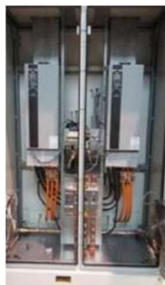
Convertidores de frecuencia de variadores del compresor + conexión de alimentación principal
